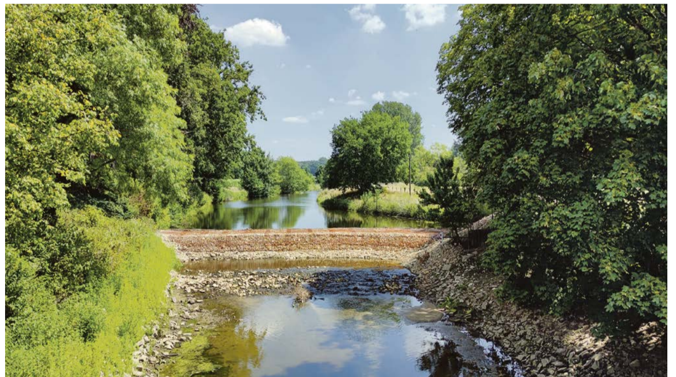
Der provisorisch angelegte Damm vor dem Wehr der Mühle sorgt dafür, dass die Stever in Olfen wieder Wasser führen kann.
