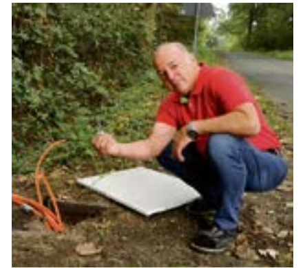
Manfred Casper zeigt einen Vandalismusschaden. Hier wurde eine Anschlusskasten herausgerissen.
