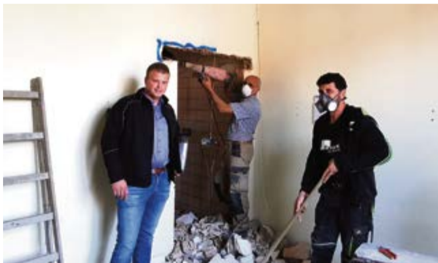
Unter Bauleitung von Fabian Schulte im Busch von der Stadt Olfen werden die Umkleiden an der Turnhalle in Vinnum saniert. Ein Neubau für Umkleidemöglichkeiten am Sportplatz wird zeitnah folgen.
