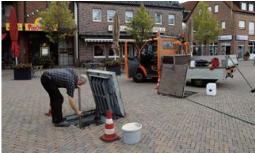
Die aufwändige Brunnen-Technik unter dem Marktplatz muss regelmäßig gewartet werden, um besonders den Kindern im Sommer Wasserspaß zu garantieren.
