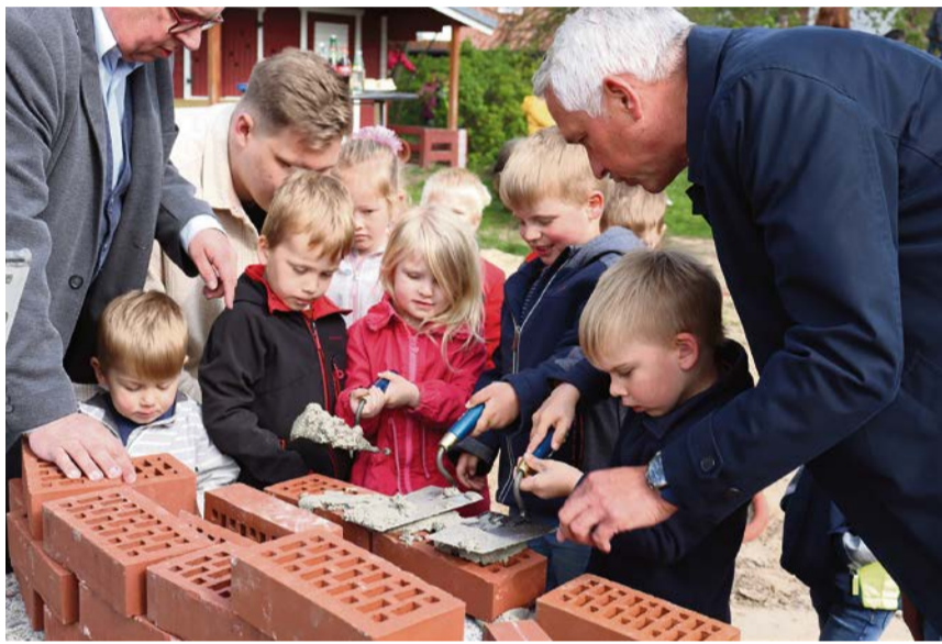
Einmal selbst mauern: Das war für die Kita-Kinder zur Grundsteinlegung das Highlight.
