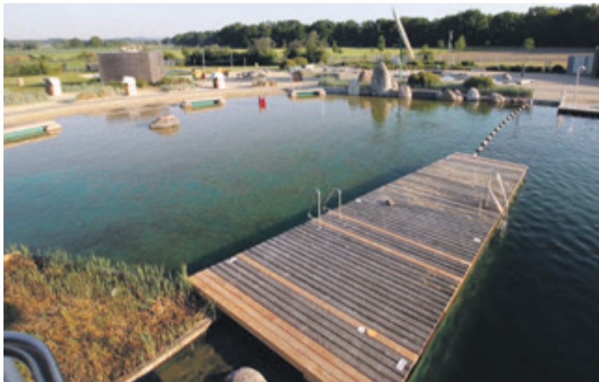
Im Naturbad stehen in den nächsten Jahren mehrere Sanierungsmaßnahmen an. Dazu gehört der Austausch der verschiedenen Holzdecks.
